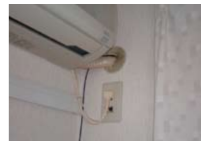
エアコンダクトを利用
